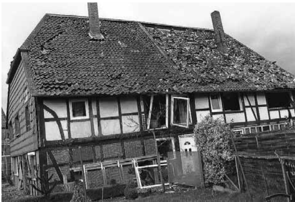
Das zerstörte Wohnhaus nach der Gasexplosion.
